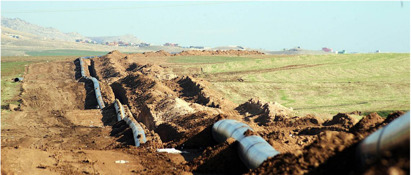
Verbindet und trennt: Kurdische Pipeline in der Nähe von Dohuk.
